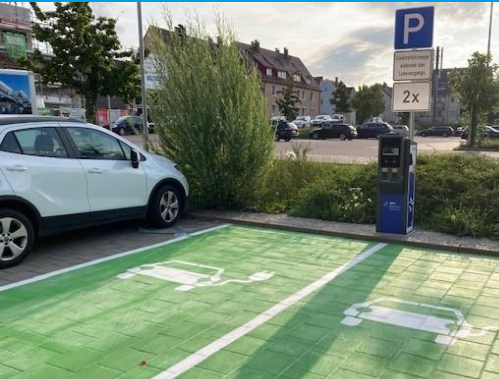
Ladesäule in Gemmrigheim; Bildquelle: Gemeinde Gemmrigheim
