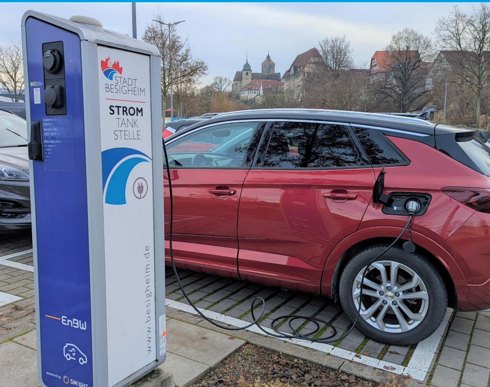
Ladesäule am Parkplatz Kleines Neckerle, Stadt Besigheim; Bildquelle: S. Thoma
